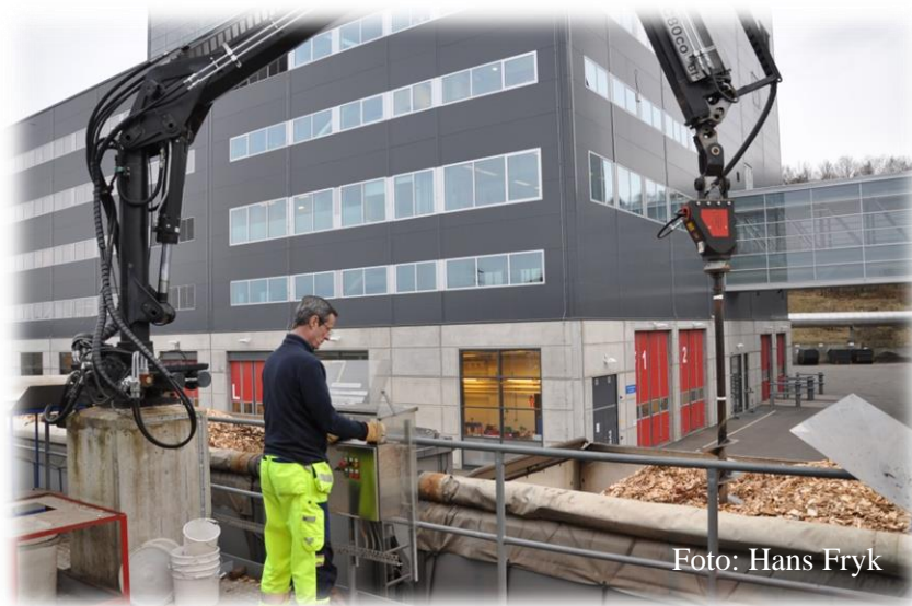
Figur 1. Översiktlig bild över hur kranen är monterad vid mätbrygga, varifrån styrning sker, samt hur borren är designad för att kunna ta prover från inkommande leveranser.
